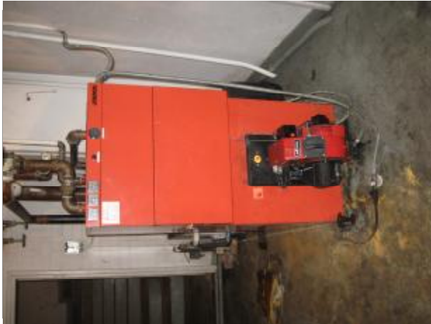
25. Keskuslämmityskattila, toinen öljyputki on poistettu ja öljynsuodatin kattilan yhteyteen (käännä)
