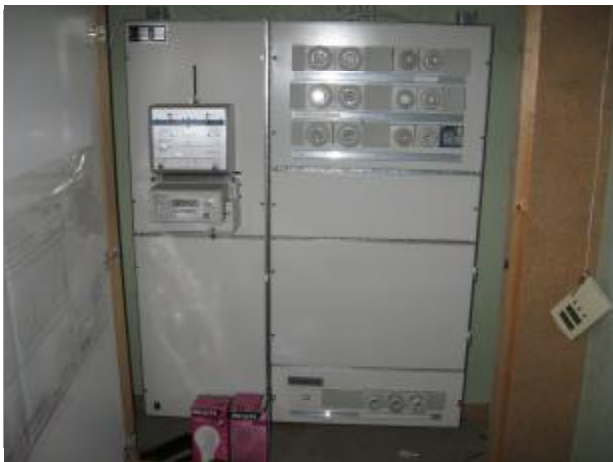
29. Sähköpääkeskus, länsipään portaikon alaosassa
