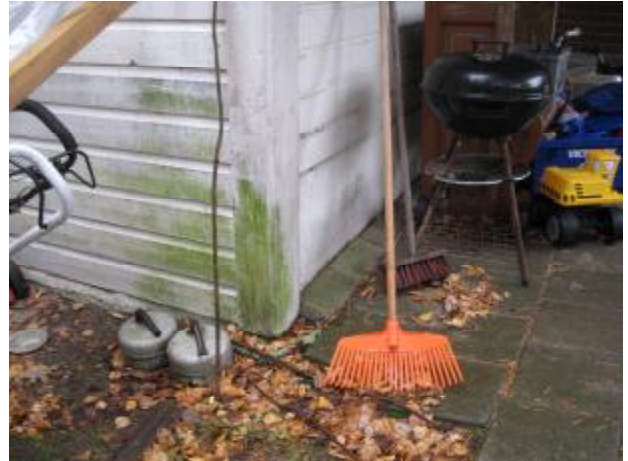
8. Laajennusosan kuistin puurakenteet lähellä maanpintaa sisäänkäynnin puoleisen sivun alaosa pellitetty
