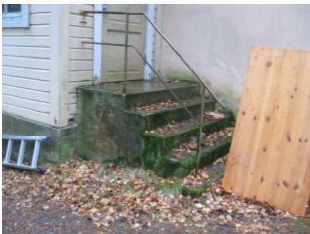
11. Itäpään kuistin ulkoporras, sammaloitumista, kuistin seinien alaosissa hieman lahoa
