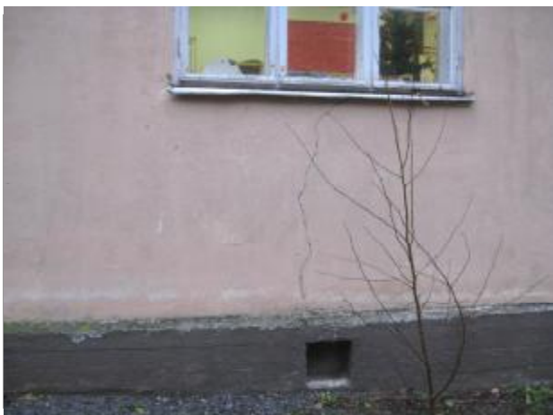
15. Vähäinen halkeama länsipäädystä
