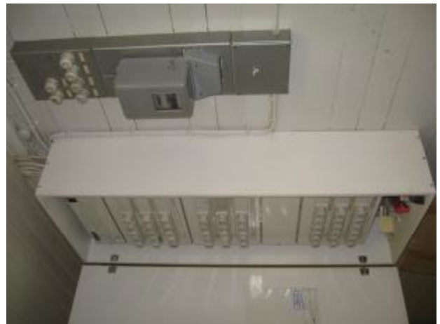
30. Ryhmäkeskus ja sähkömittari, ullakkokerroksessa (käännä)
