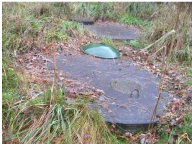
14. Saostuskaivot, rakennuksen eteläpuolella
