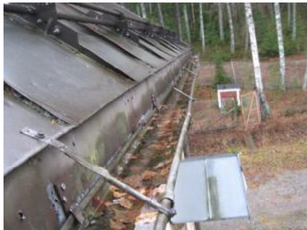
20. Tukkoisuutta pohjoispuolisessa räystäskourussa
